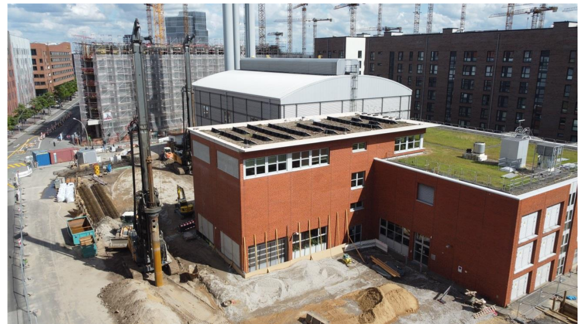
Null Emissionsbürogebäude Hafencity Hamburg GmbH Architekten Heinle Wischer Gesellschaft für Generalplanung mbH
